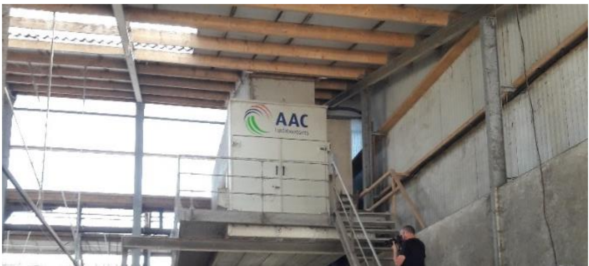
Figuur 13: De bezochte chemische luchtwasser in een natuurlijk geventileerde stal
